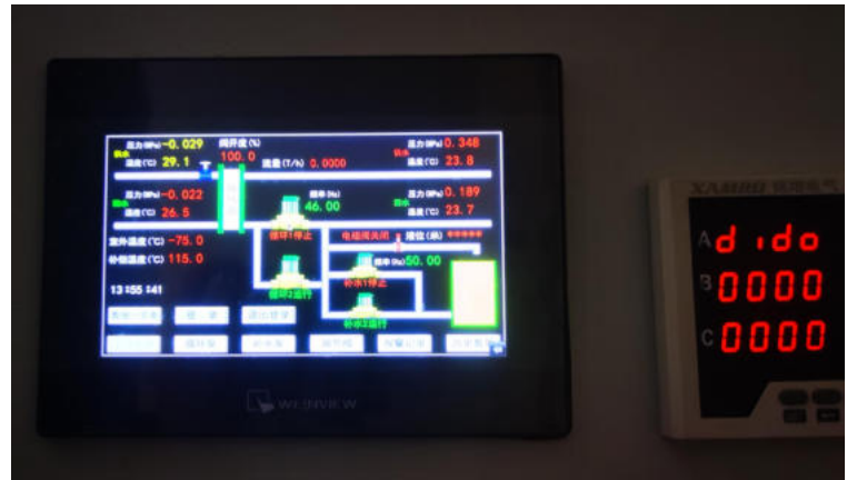
东乡中学换热站
