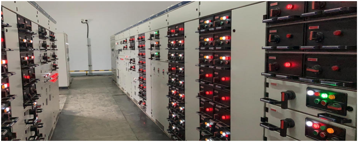
引汉济渭高压室
