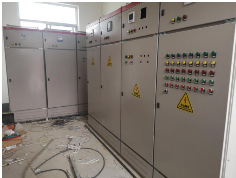
什川灌溉泵站动力控制柜
