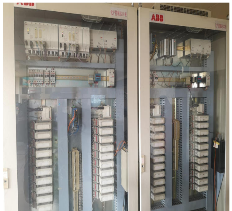
青海庆华煤矿 DCS 系统
